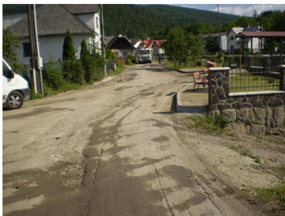
Miestna komunikácia pred rekonštrukciou
